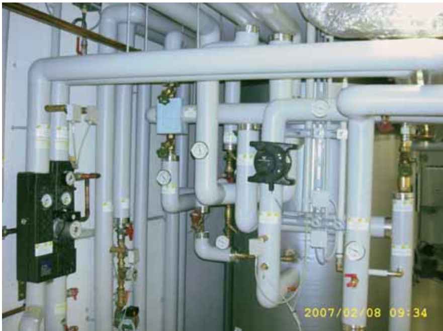
Auch Kälteverteilungs- und Kaltwasserleitungen müssen nach der EnEV 2009 gedämmt werden.
